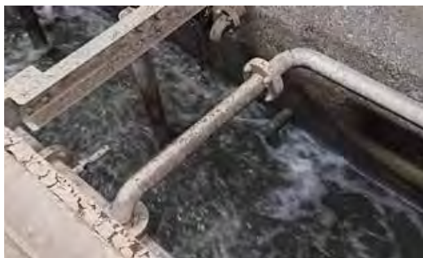
写真1: 汚水に空気を送る反応槽(11/29～)
