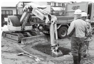
水道管破裂後の素早い対応
