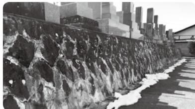
老朽化した坂田霊園の擁壁
