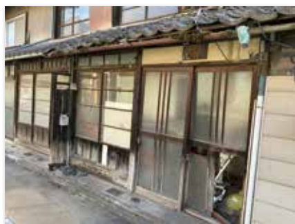
管理がされていない空き家
