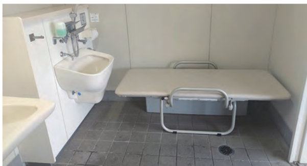
多目的防災広場のトイレに設置されているユニバーサルシート
