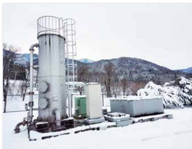
水漏れ対策の決め手！ エアレーション設備（八町水源）
