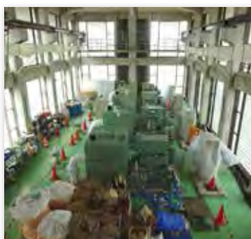
令和4年復旧予定の送風機設備
