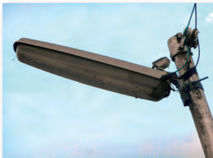
交換を待つ蛍光灯防犯灯
