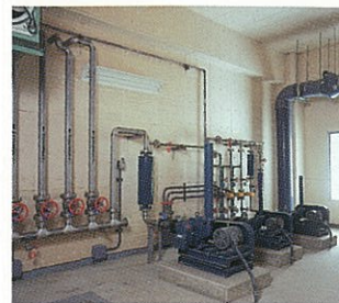
■ブロワー 各槽の散気、攪拌、逆洗、エアリフト用空気として圧送されます。
