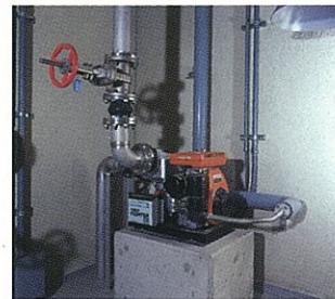
■非常用エンジンポンプ 停電に際し、自動的に非常用エンジンポンプが作動いたします。
