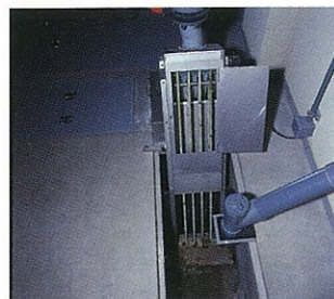
■自動粗目スクリーン 流入汚水中の大きなし渣類をあらかじめここで除去します。
