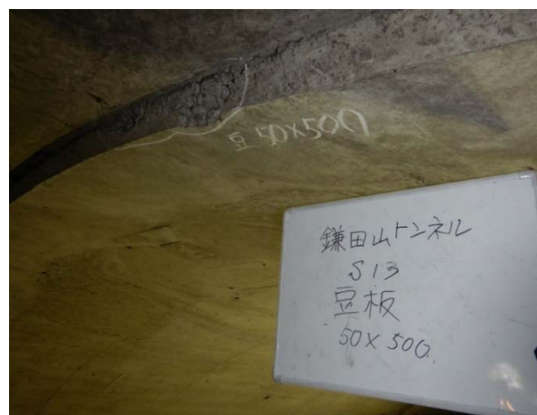
アーチ天端付近の豆板 (0.05m × 0.5m) 判定区分Ⅱb
