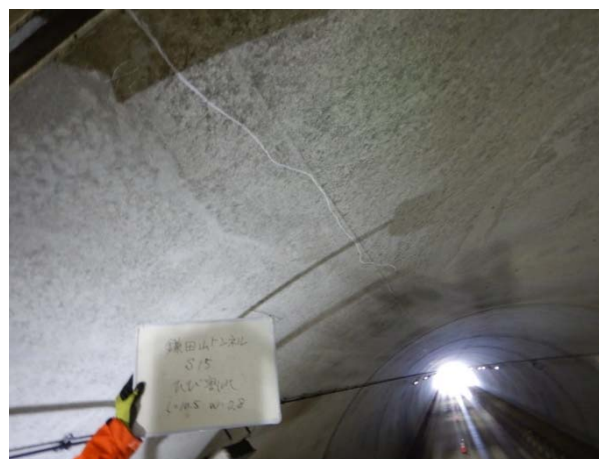
アーチ天端付近のひびわれ (ひびわれ長さ 10.5m、幅 0.8mm) 判定区分Ⅱb
