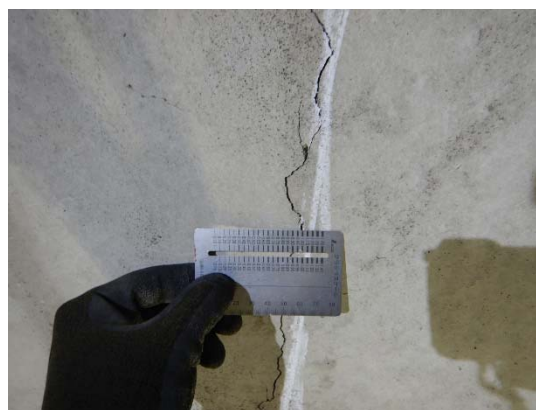
ひびわれ幅計測状況
