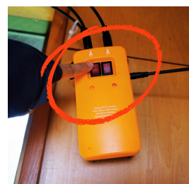
第1キャンプ場トイレ内 スイッチ
