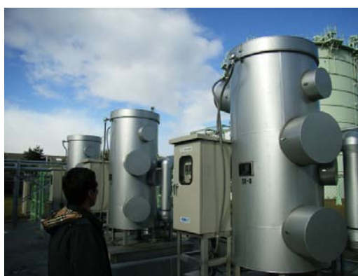
バイオガス精製装置
