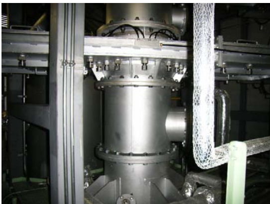
燃焼プラント
