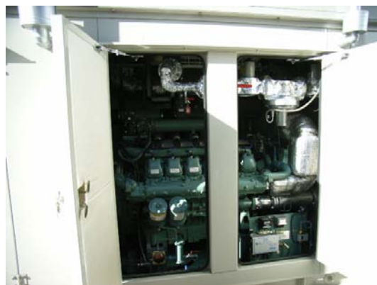
発電用ガスエンジン
