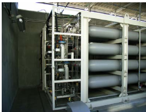
水素ガスタンク
