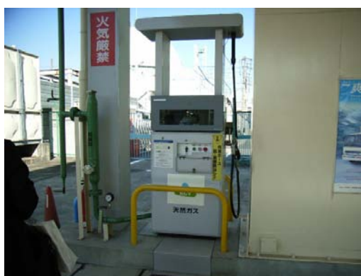
圧縮天然ガススタンド
