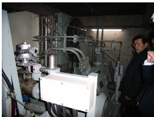
圧縮ガス製造装置（スタンドの地下）
