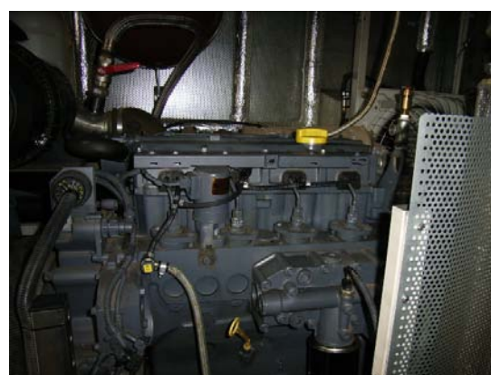
発電用ガスエンジン
