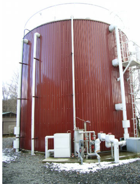
メタン発酵棟
