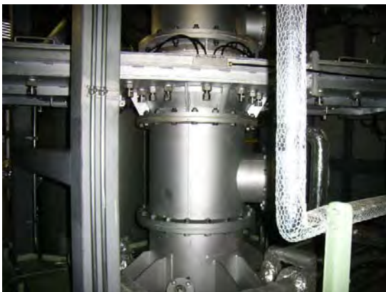
燃焼プラント
