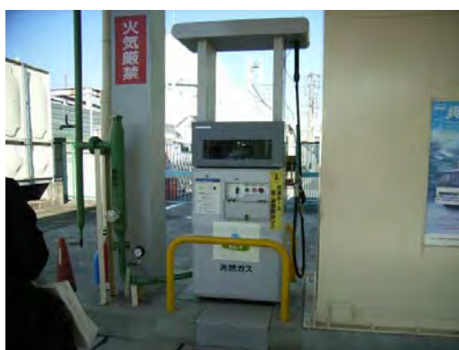
圧縮天然ガススタンド
