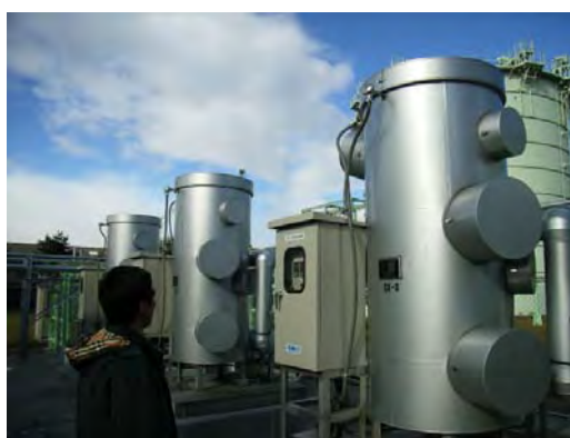
バイオガス精製装置
