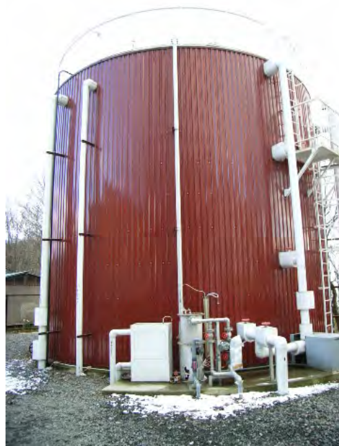
メタン発酵棟
