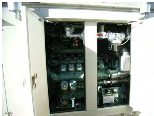
発電用ガスエンジン
