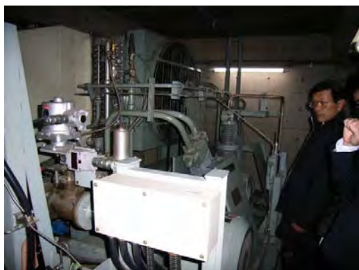
圧縮ガス製造装置（スタンドの地下）
