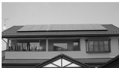
図 3-14 家庭用 PV システムを設置した家屋
