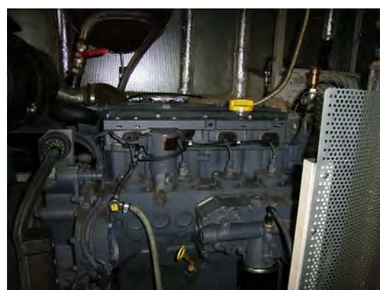
発電用ガスエンジン
