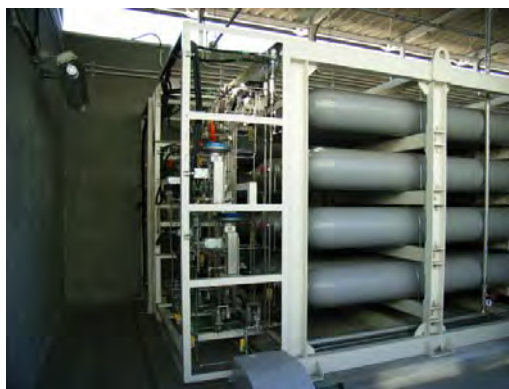
水素ガスタンク
